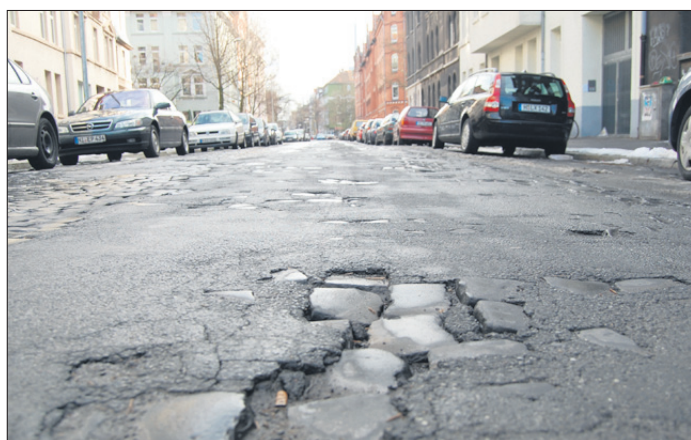
Steht nicht auf der Sanierungsliste: die Wilhelm-Bluhm-Straße.
