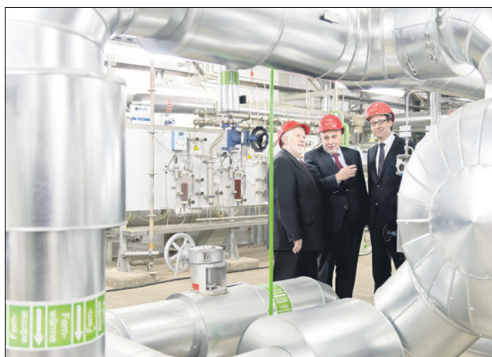
Besichtigten die neue Anlage direkt vor Ort (v.l.): Umweltdezernent Hans Mönninghoff, Stadtwerke-Chef Michael Feist und Niedersachsens Umweltminister Dr. Stefan Birkner.
